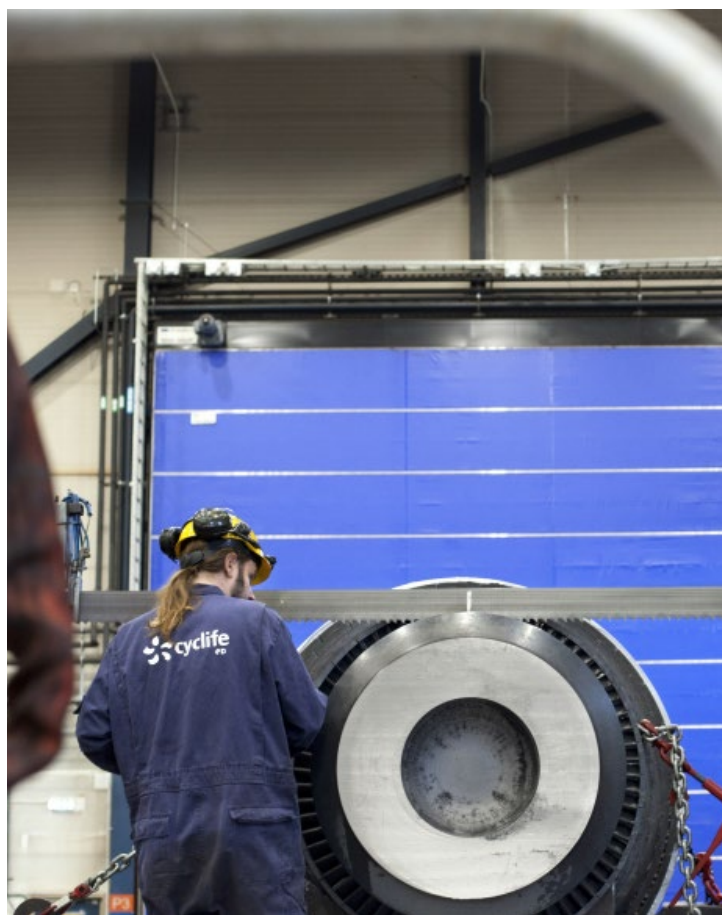
Opération de découpe d'un composant métallique sur le site de Cyclife Sweden
