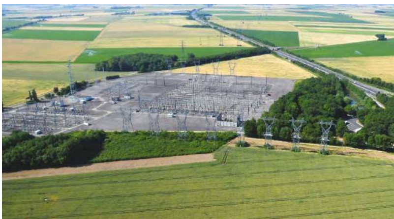
Figure 21 : Poste RTE de DAMBRON (RTE, 2014)
