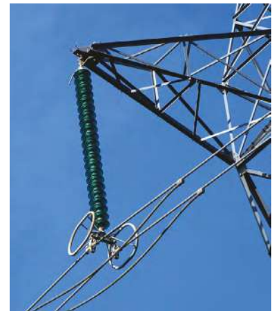
Figure 18 : Exemple de chaîne d'isolateurs à 400 000 volts (RTE, 2024)
