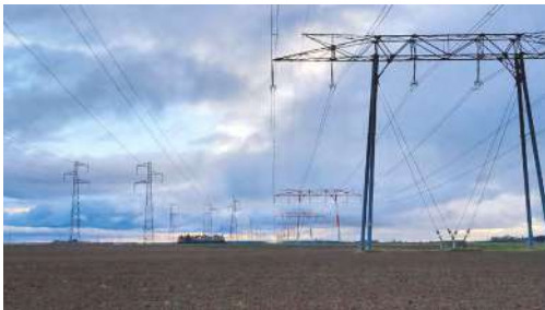
Figure 33 : Pylônes électriques spéciaux associés à la servitude aéronautique de l'aérodrome militaire 123 Orléans-Bricy à Huêtre (RTE, 2023)
