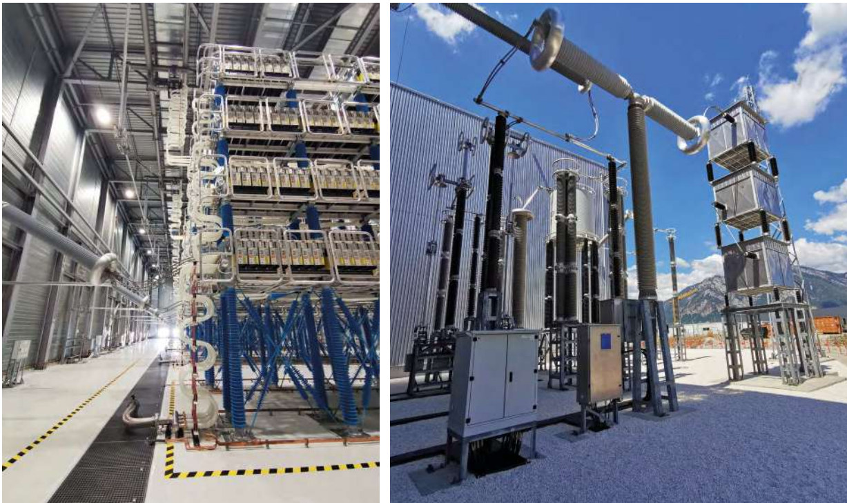
Figure 12 : Exemple de station de conversion 320 kV (intérieur et extérieur)
