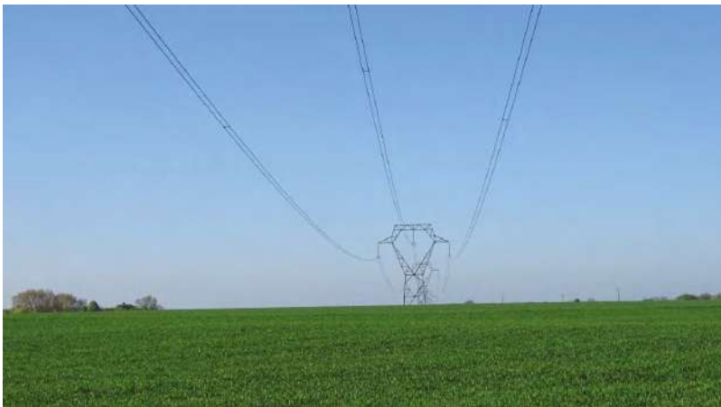
Figure 17 : Exemple de câbles conducteurs à 400 000 volts surplombant une parcelle agricole (RTE, 2024)
