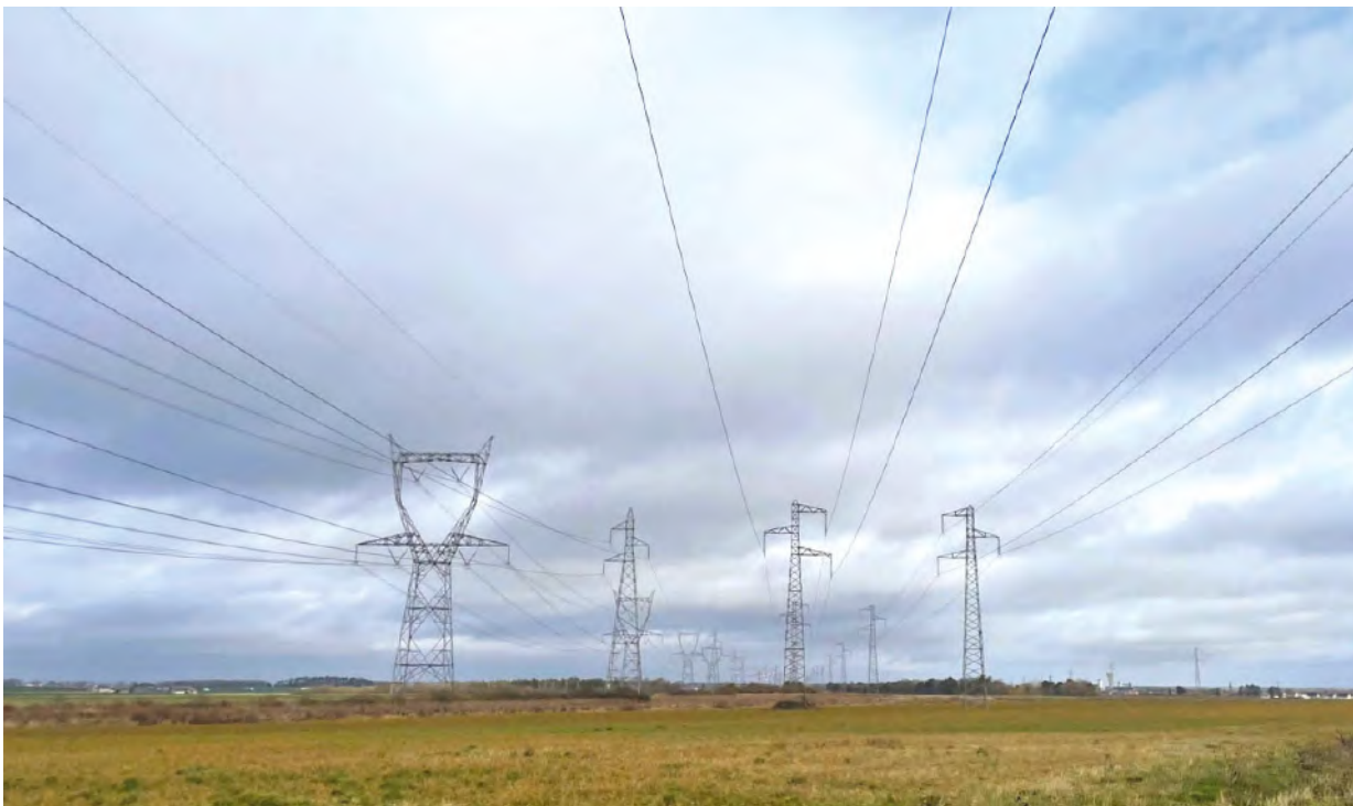
Figure 10 : Liaisons aériennes existantes dans le couloir aérien entre les postes de CHAINGY et de DAMBRON (RTE, 2023)
