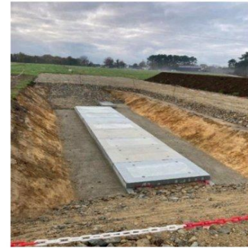
Chambres de jonction terrestres ≈ 1km
