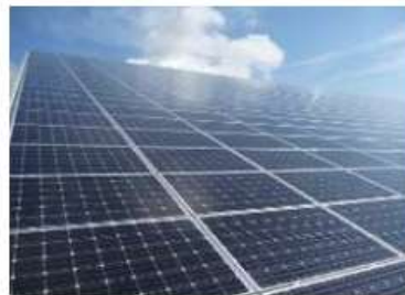
Exemple de panneaux solaires photovoltaïques
