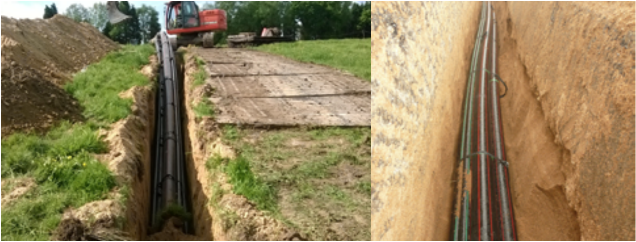
Figure 31 - Pose de câbles souterrains en fourreaux polyéthylène haute densité (PEHD) en zone rurale
