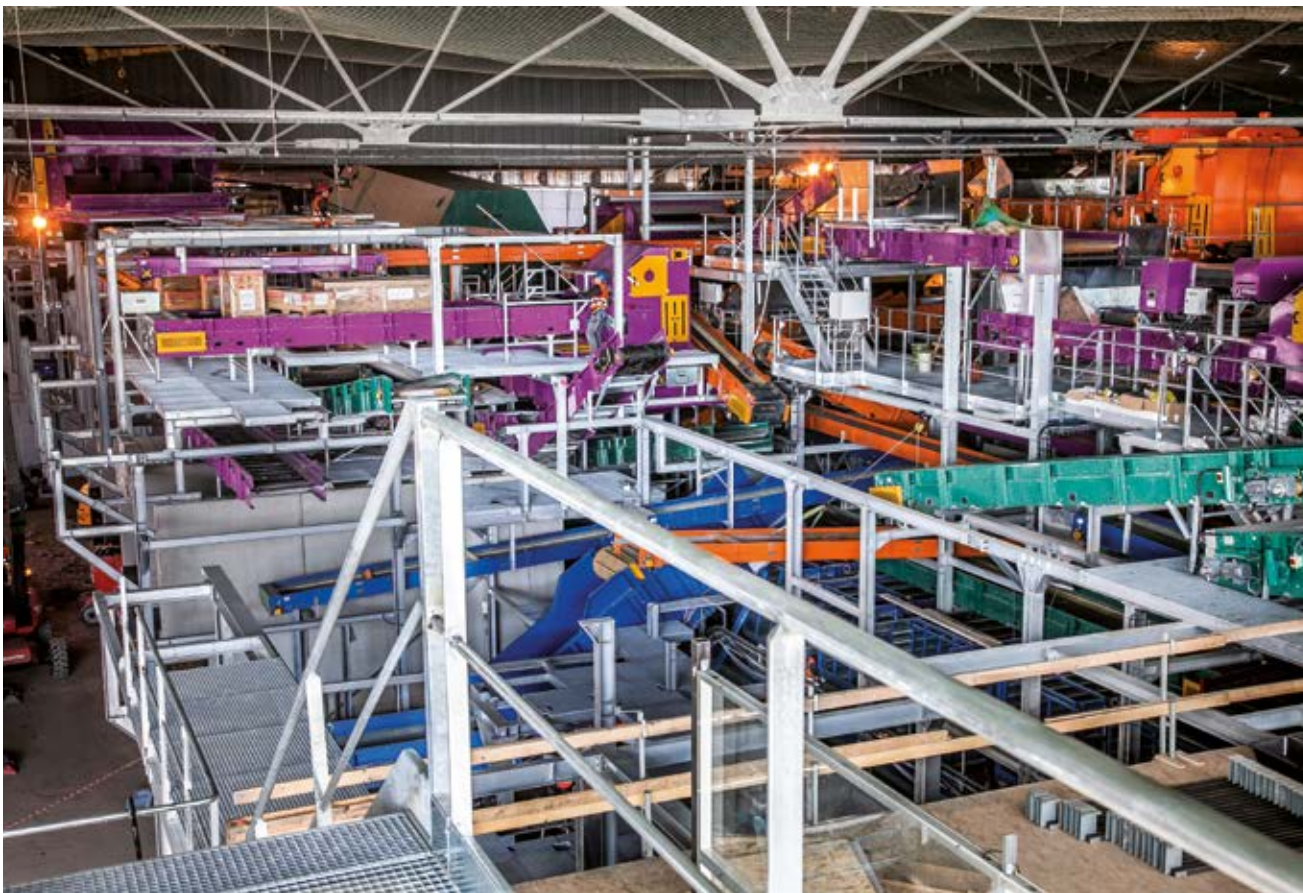
La chaîne de tri du centre à Romainville, modernisée en 2015
